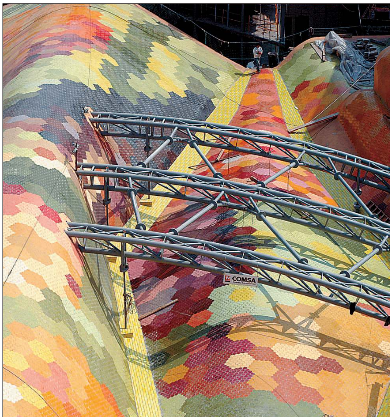
Detalle de las obras realizadas por la empresa constructora Comsa en el mosaico de la cubierta del mercado de Santa Caterina.
