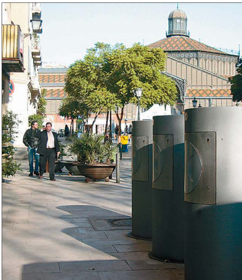
Buzones de recogida neumática de basuras instalados en Ciutat Vella.
